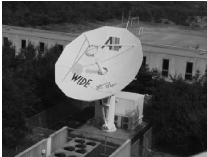
図 4.5: 中継サイト衛星アンテナ
